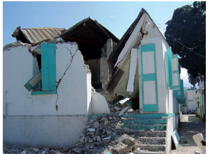
Vollkommen zerstörtes Gebäude der pädiatrischen Abteilung. Bildquelle: Cap Anamur
