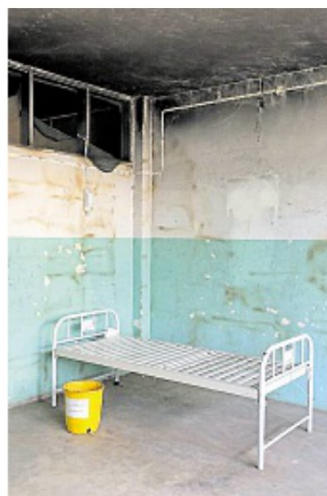
Das Gesundheitszentrum ist bei einem Terroranschlag zerstört worden. Fotos: Hillenhinrichs
